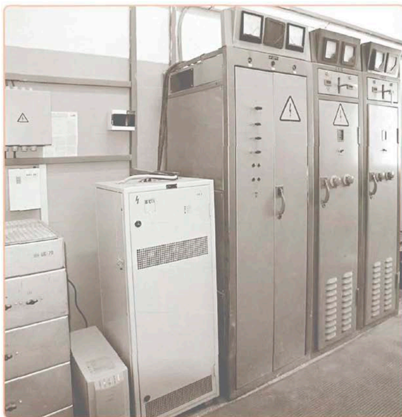
Оборудование автоматической телефонной станции
